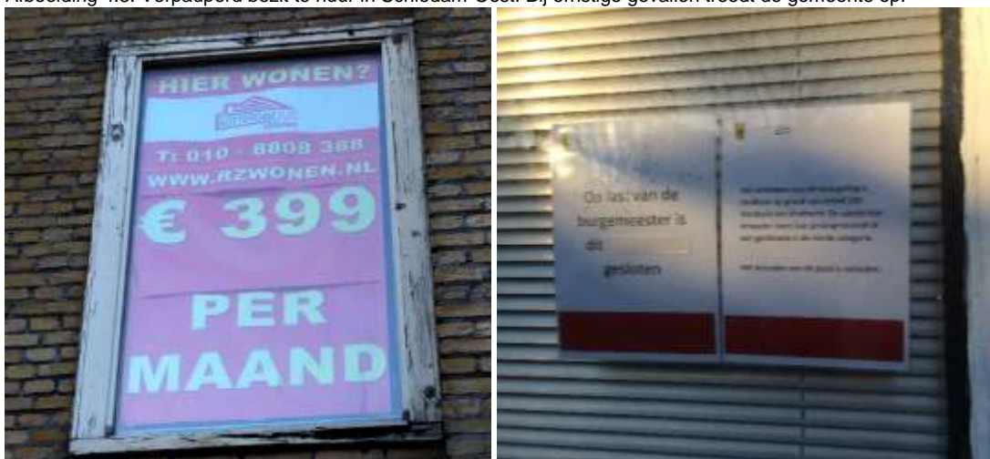
Afbeelding 4.3: Verpauperd bezit te huur in Schiedam-Oost. Bij ernstige gevallen treedt de gemeente op.
